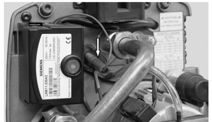
Abb. 20: Ionisationskabel mit Stecker
